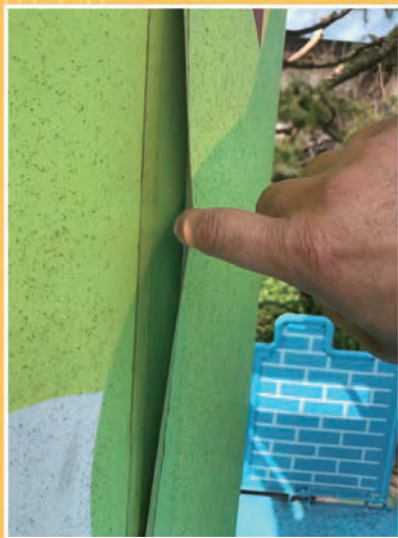
剥がれと汚れが目立ちます
